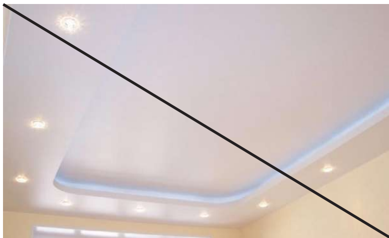
Плохо Многоуровневые гипсокартонные конструкции
